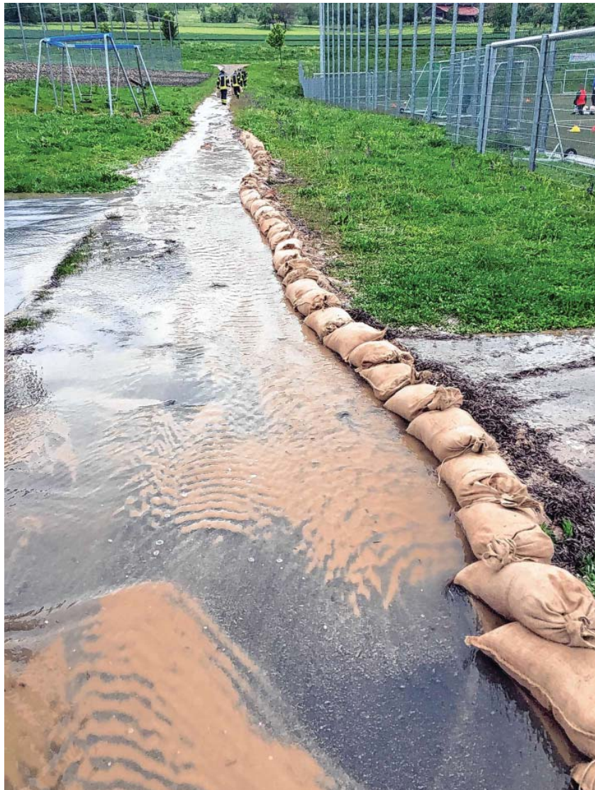
Sportanlage Arbachtal: Sandsäcke zur Lenkung des Oberflächenwassers
